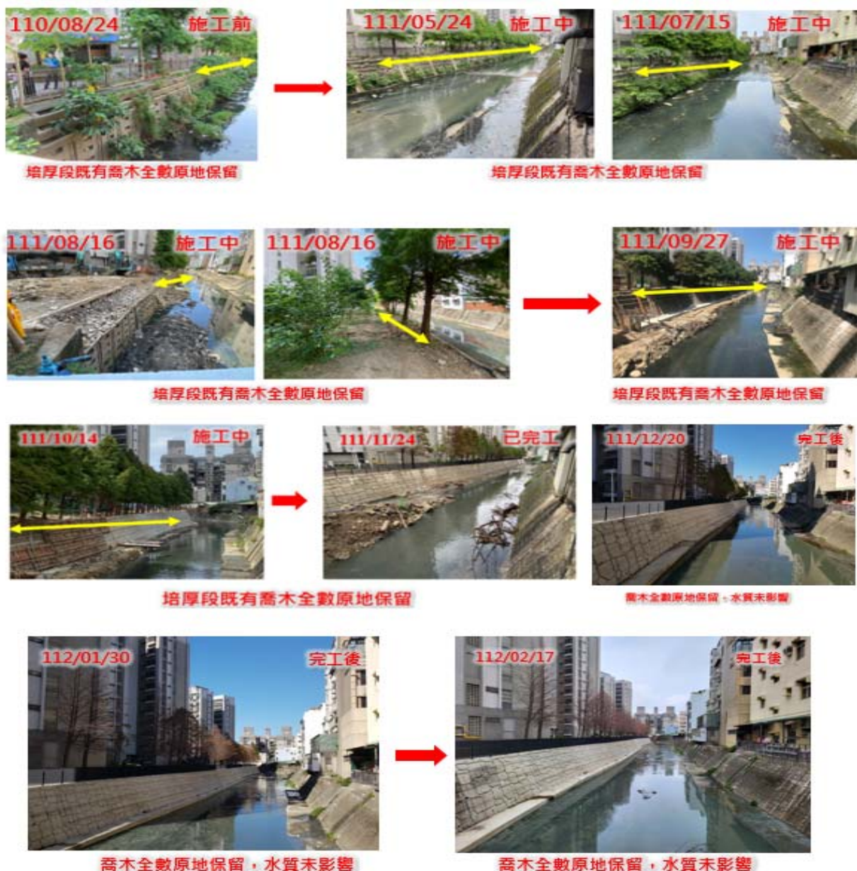
(b)施工前、中、後護岸培厚段之喬木原地保留與工程施做情況
