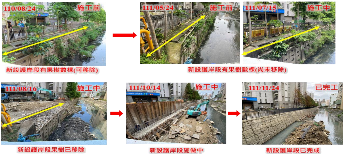
(a) 施工前、中、後新設護岸段之喬木移除與工程施做情況
