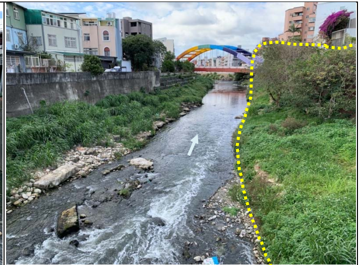
說明：印順橋上游左右岸均有箱籠結構, 往上游處左岸漸變為垂直混凝土護岸, 低水護岸部分已有濱溪植被, 以巴拉草、象草、蓖麻等外來物種為主。黃線範圍為建議保留區域 日期：2022. 01. 19
