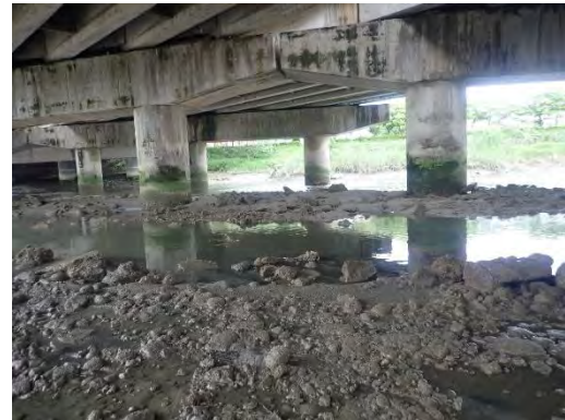
出海口泥沙淤積嚴重，水色混濁
